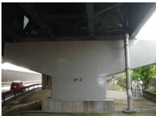
写真 - 18 外観モニタリング (2年後)
