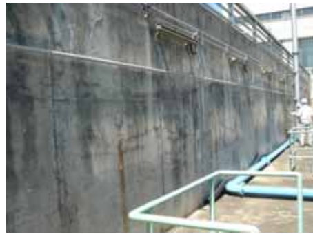
写真-1 A S R による劣化状況（全景）
