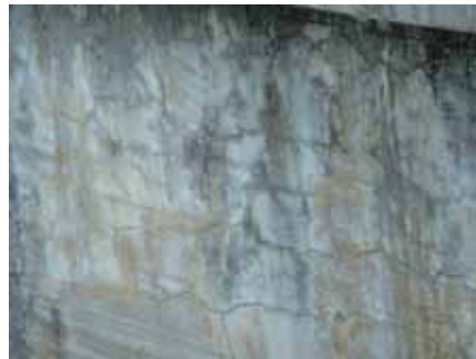
写真-2 A S R による劣化状況（接写）
